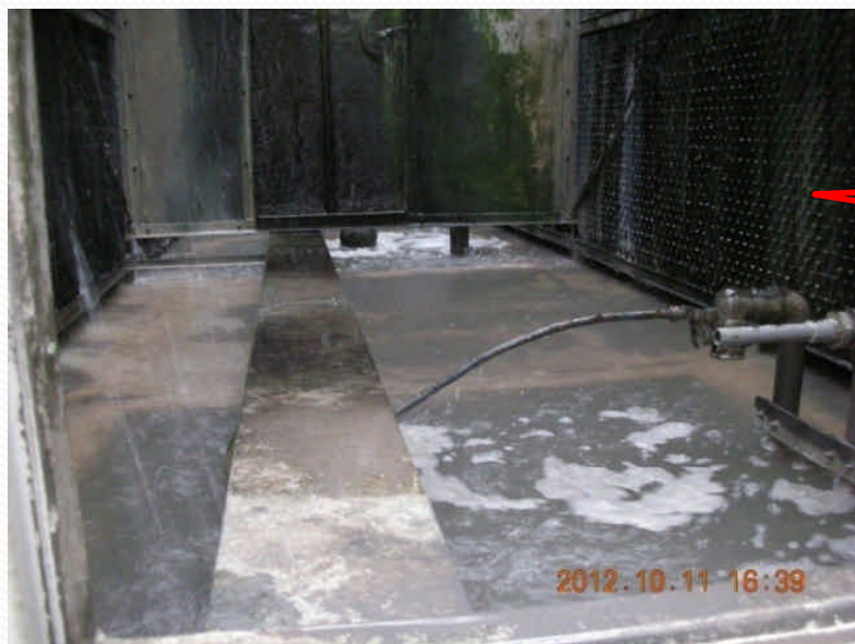
500RT x 2冷卻水塔
